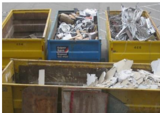
5 сурет – Құрылыс қалдықтары сұрыптталатын болады және әрі қарай құрылыс алаңы шегінен тыс жерде тиісінше кәдеге жарату / қайта өңдеу үшін уақытша құрылыс алаңына жиналады
