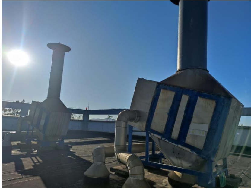
图 11 燃气锅炉的烟囱
