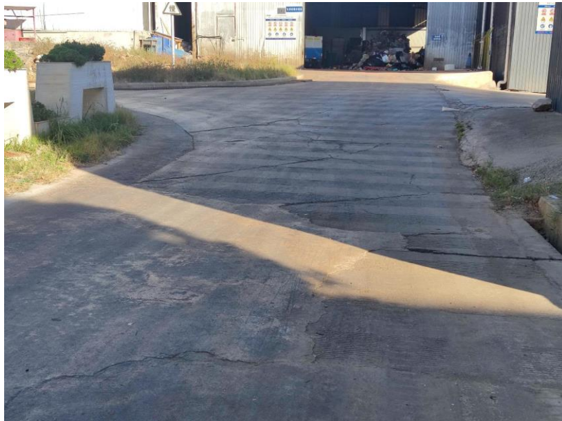
图 6 生活垃圾暂存区混凝土地面裂缝
