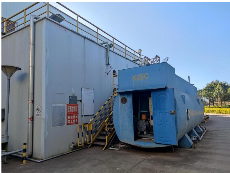
图 7 生活垃圾渗滤液处理装置
